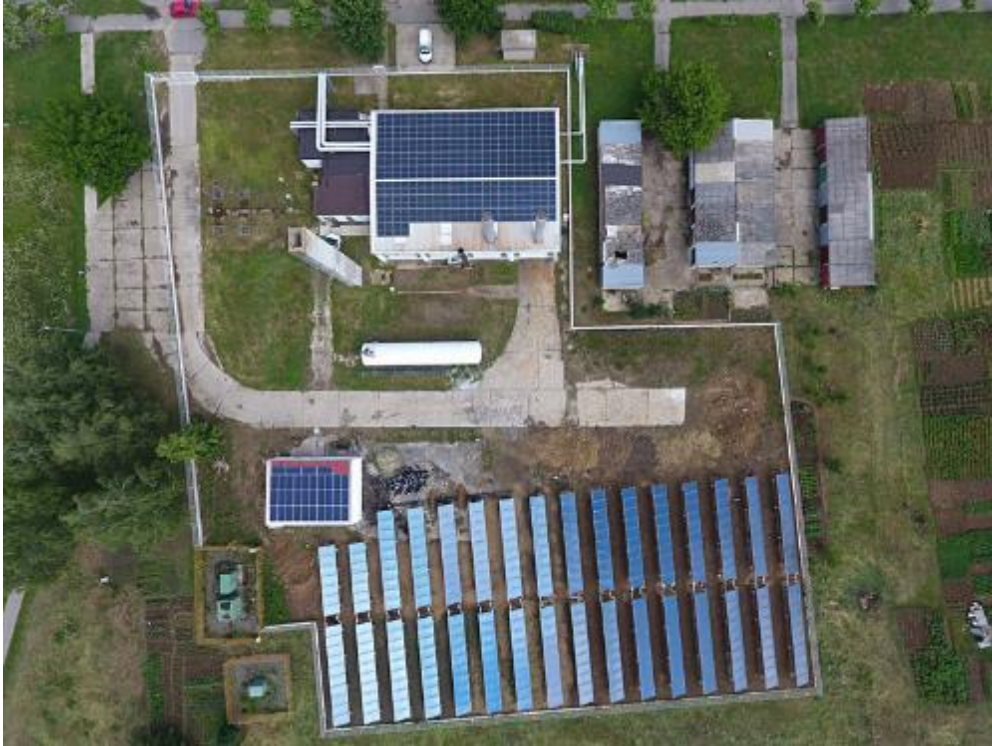
Slika 2 Fotonaponska elektrana i solarno termalno polje u sklopu toplane u Borovu naselju 7
