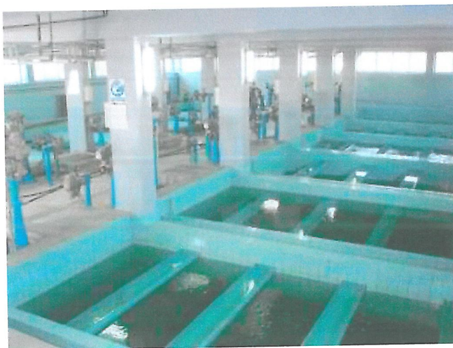
Slika 2.3. Postrojenje za filtriranje vode
